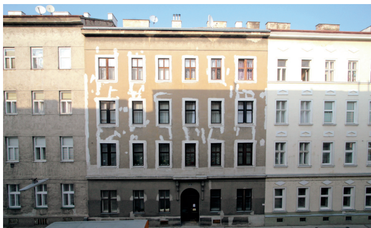
PREMIERE. Zum ersten Mal wird in Wien ein Gründerzeithaus so saniert, dass es mit modernen Niedrigenergiebauten mithalten kann.
