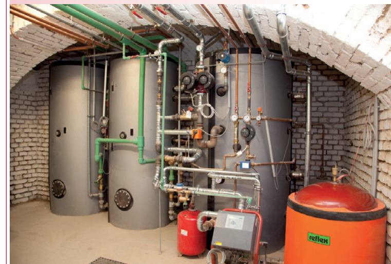
Wißgrill-Heizraum Foto: Ulreich Baurträger GmbH
