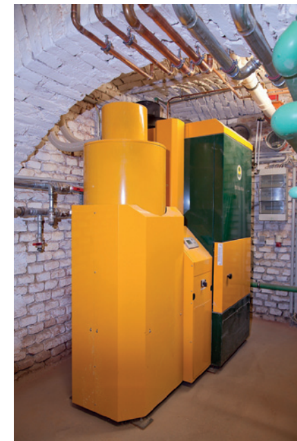
Moderne Haustechnik und eine Pelletsheizung wurden in das historische Gebäude integriert. Foto: Ulreich Baurträger GmbH
